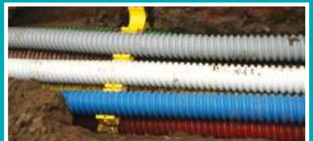
Bảo vệ cáp thông tin Protect communication cables
